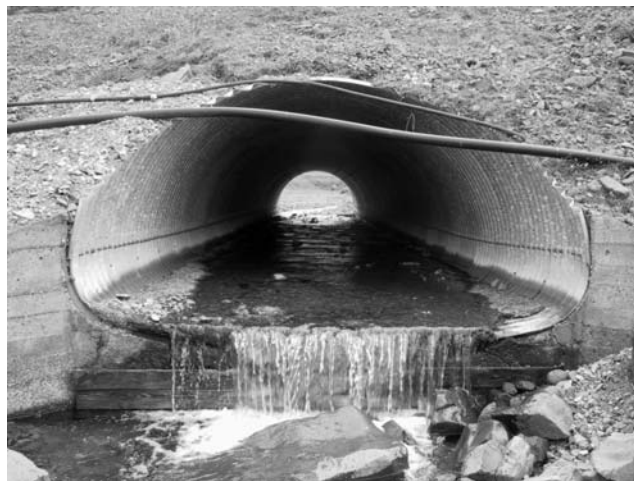
Plötustálrör. Greinileg ryðmyndun í botni
